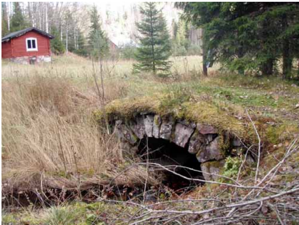
Figur 17. Stenvalvsbron, Grythyttan 356:1. Källarstugan syns i bakgrunden till vänster. Foto: Åsa Westin, mot NO.
